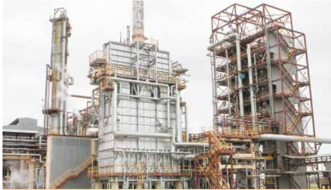
Установка «Юникрекинг» комплекс «Гидрокрекинг».
